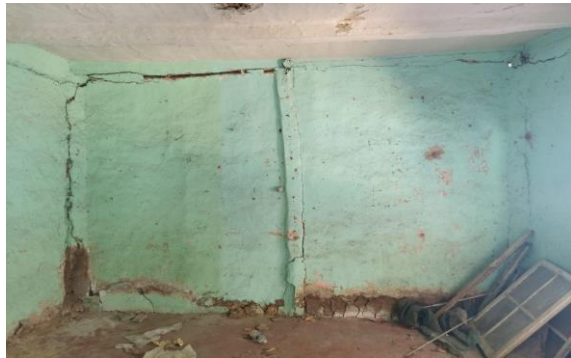
Figura 12. Agrietamiento en el recubrimiento interior del inmueble
