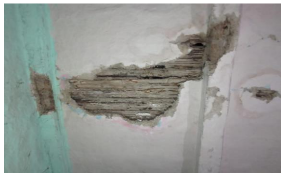
Figura 14. Caída de recubrimiento en losa debido a las filtraciones de agua
