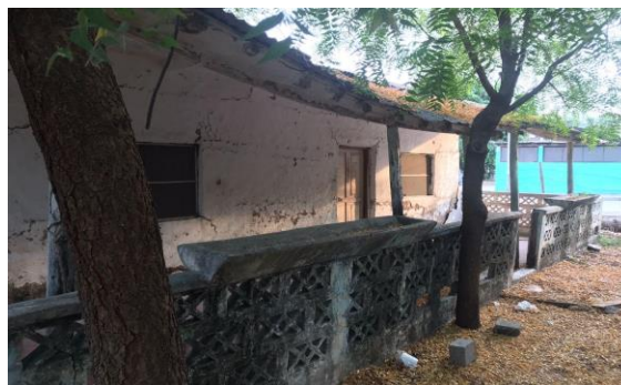
Figura 15. Hundimiento de losa después de la caída de un árbol sobre esta
