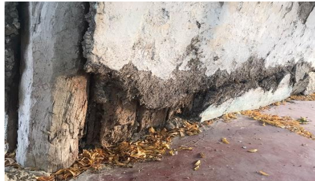
Figura 13. Agrietamiento y caída de recubrimiento en muros exteriores del inmueble
